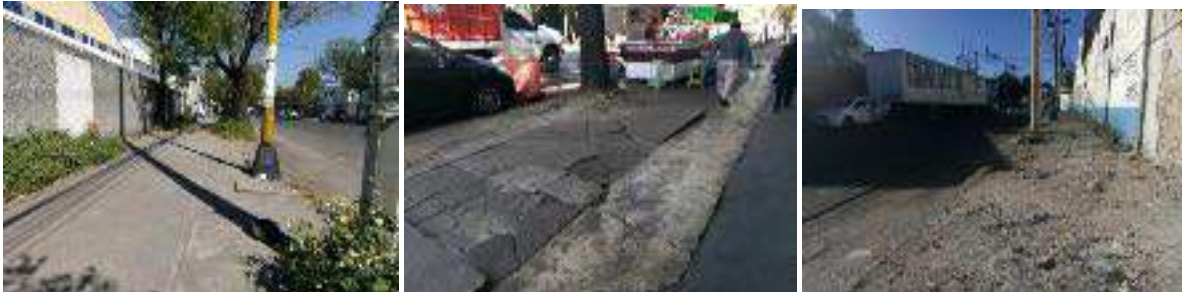
Imagen 100. Estado de conservación de las banquetas en la zona del PPDU Vallejo
